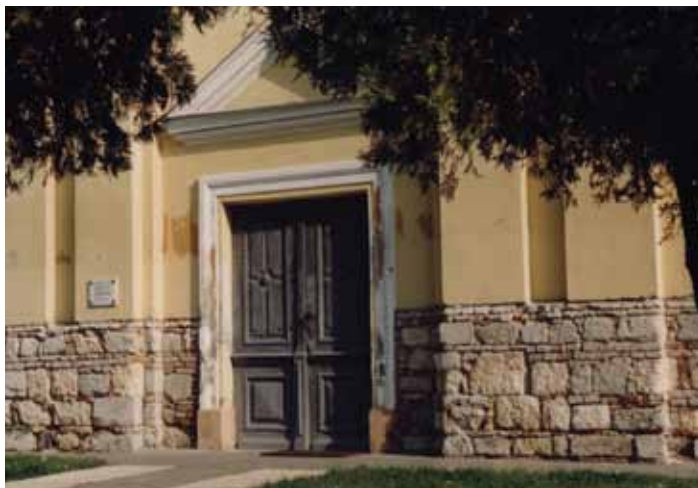
15. Az 1822–1824 között emelt Vártemplom nyugati homlokzata 1994-ben. A vakolattól megtisztított lábuzatában jól láthatóak az uralkodó dzsámiból származó faragott kövek és téglák. Irás Mátyás felvétele
